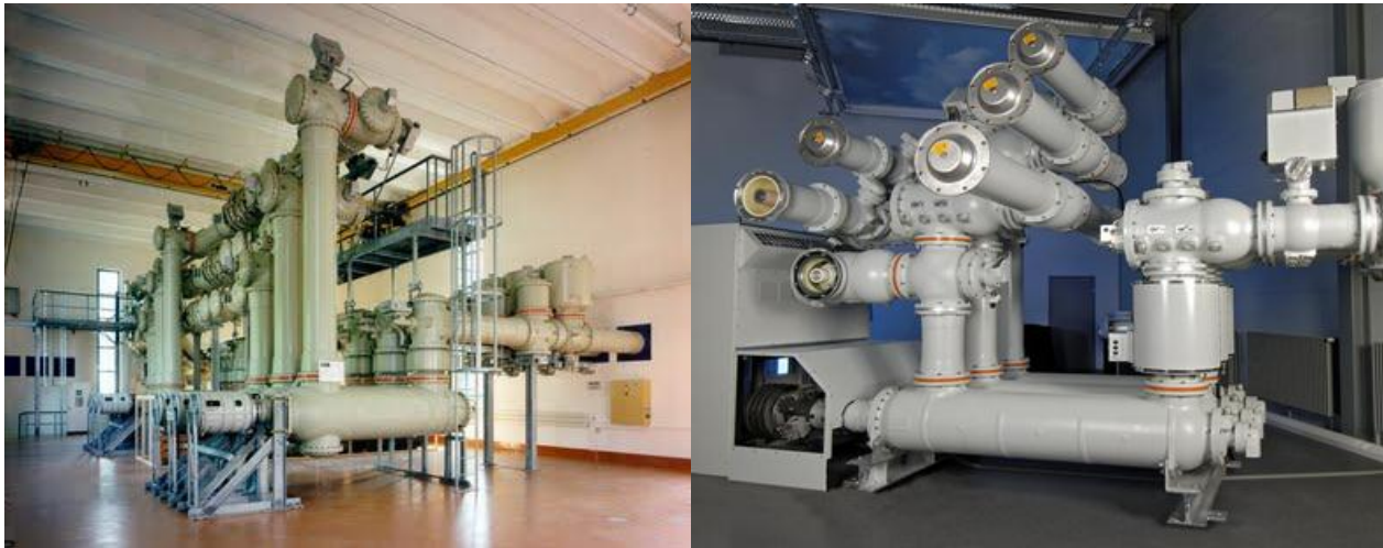
Figura 6-7 Subestación encapsulada tipo GIS
