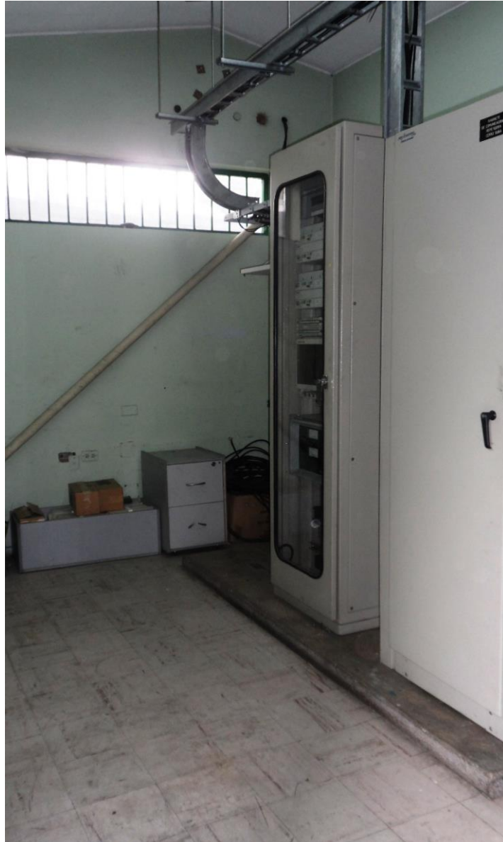
CERRO SUBA - SALON DE EQUIPOS MICROONDAS Y CONTROL SCADA
