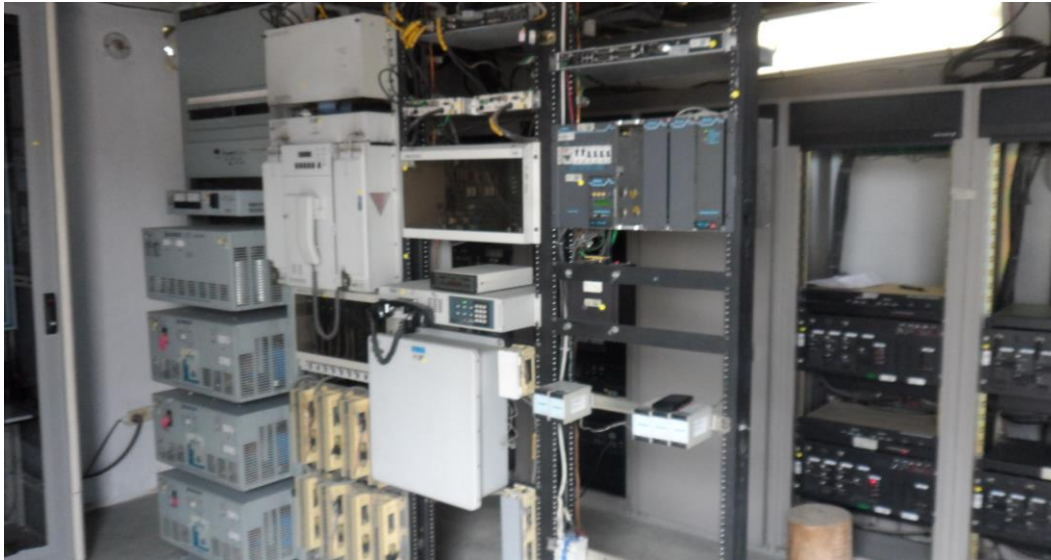
SIERRA MORENA - BASTIDORES EQUIPOS MICROONDAS
