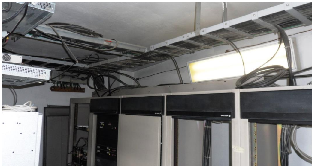
SIERRA MORENA - SALON DE EQUIPOS MICROONDAS Y CONTROL SCADA
