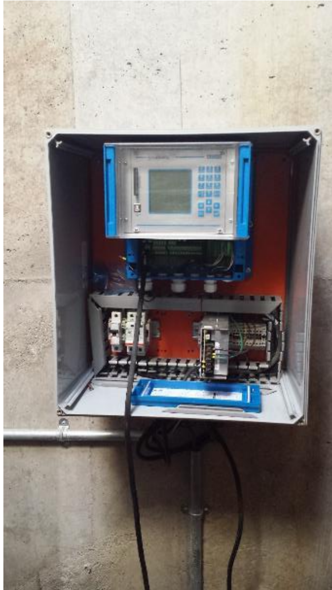
FOTO No. 44 TABLERO DE FLUJOMETRO.
