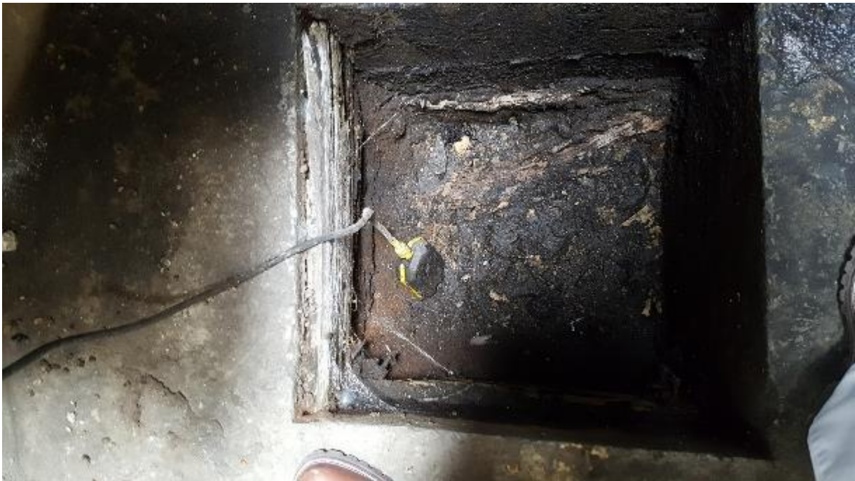
FOTO No. 27 POZO BOMBA DE ACHIQUE Y FLOTADOR.
