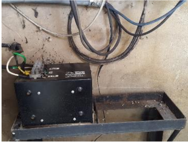
FOTO No. 26 BATERÍA.
