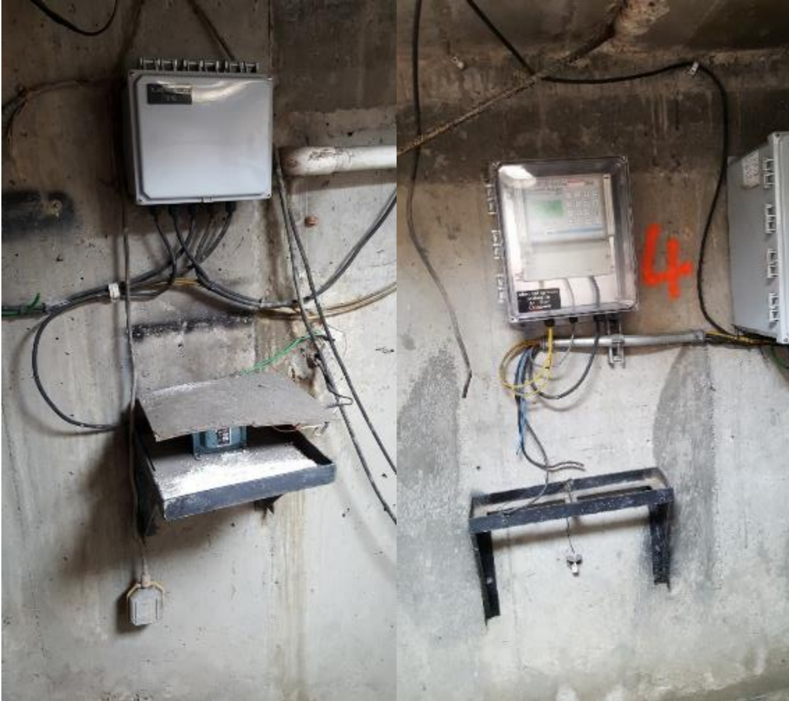
FOTO No. 10 CABLEADO EN MALAS CONDICIONES.
