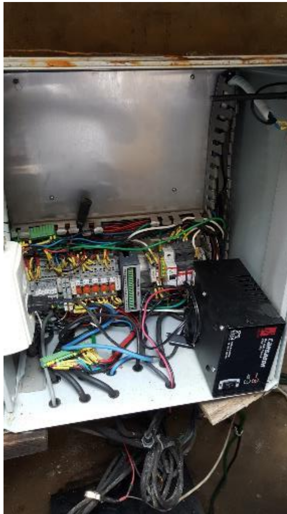
FOTO No. 35 SISTEMA RTU
