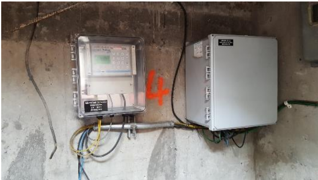
FOTO No. 9 FLUJOMETRO Y TABLERO DE CONTROL RTU.
