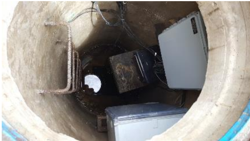
FOTO No. 31 TABLEROS RTU, FLUJOMETRO Y DISTRIBUCIÓN.
