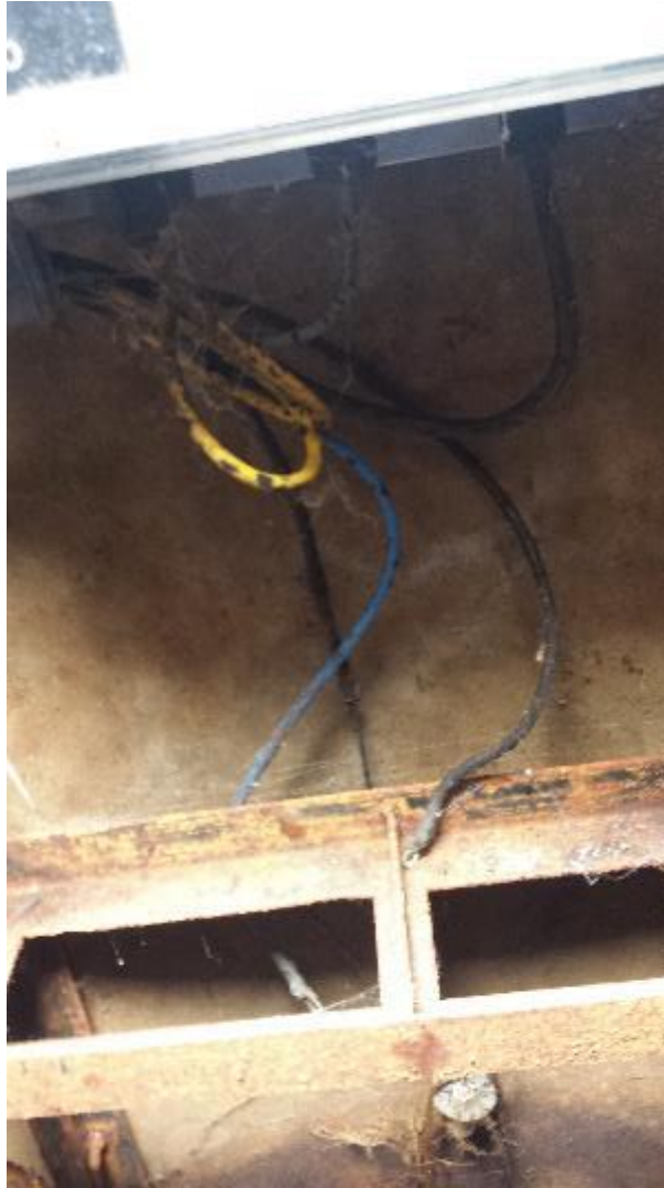
FOTO No. 50 FALTA FLUJOMETRO Y BATERIA.
