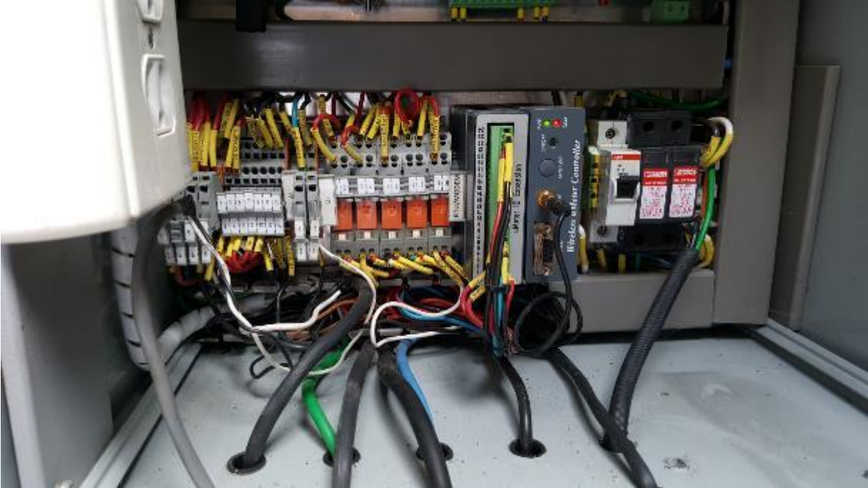
FOTO No. 28 SISTEMA RTU
