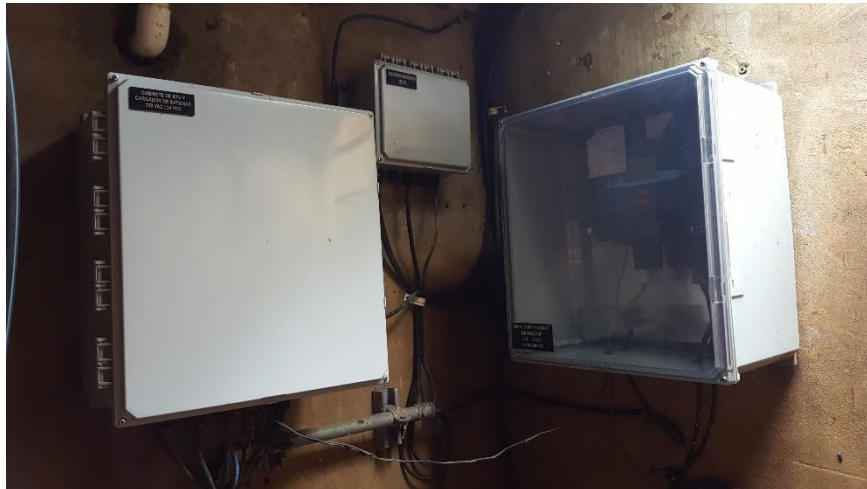
FOTO No. 61 TABLERO INTERIOR IP68 PROPUESTO
