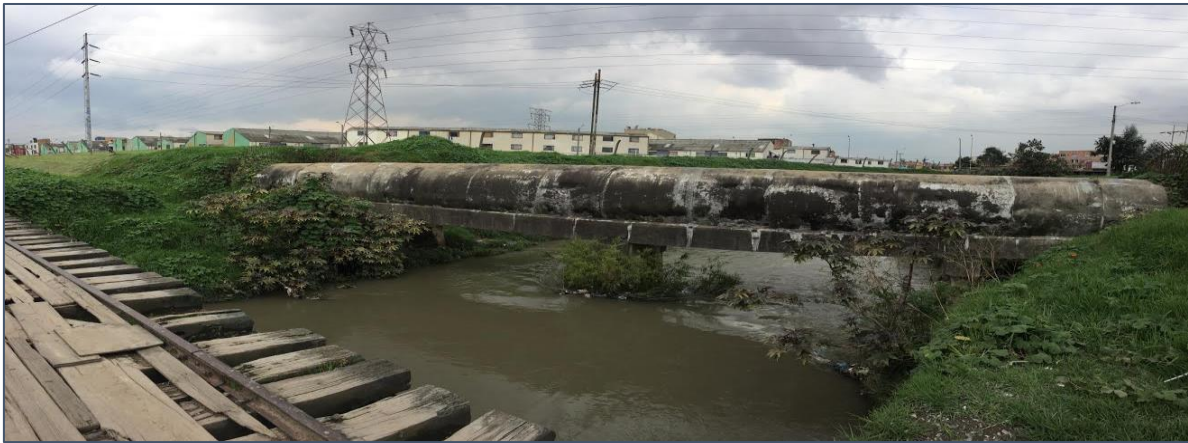
Vista viaducto río Tunjuelo “nótese estado de deterioro” Fuente: Contelac S.A.S
