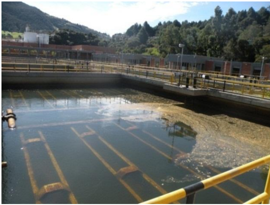
Figura 1. Tanques de filtro planta Wiesner
