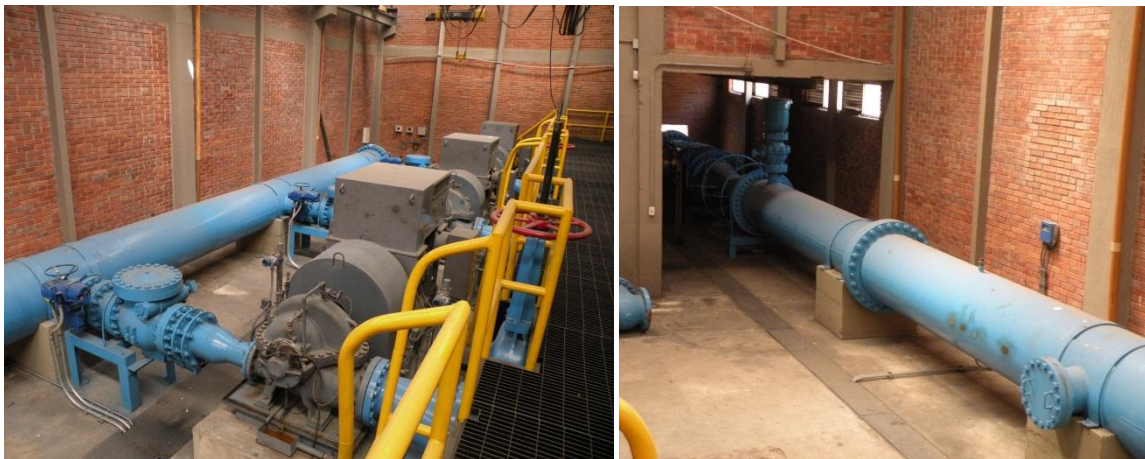
Figura 11. Unidades de bombeo de Sierra Morena I Figura 12. Succión Línea 78" Tibitoc- Casablanca
