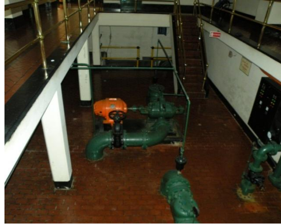
Figura 8. Cuarto de Bombas-Consuelo y San Dionisio
