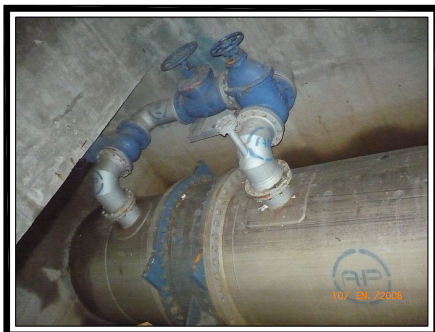
FOTO No. 3 Detalle By-Pass
