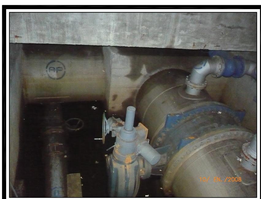
FOTO No. 4 Vista Purga (Linea 60")
