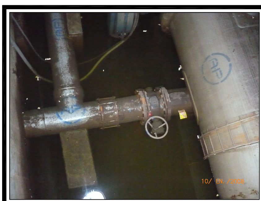
FOTO No. 5 Vista Purga (Linea 78")
