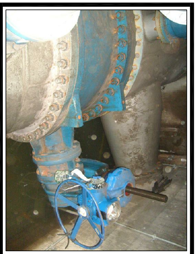
FOTO No. 2 Vista de la Valvula V-39
