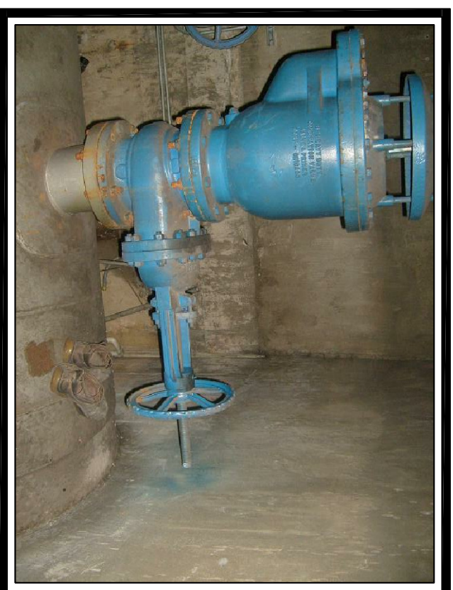
FOTO No. 5 Vista de la Ventosa Accesorio 177B
