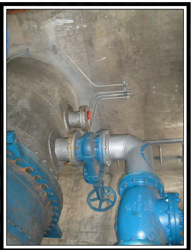
FOTO No. 3 Vista – Falta Instalacion Ventosa Norte
