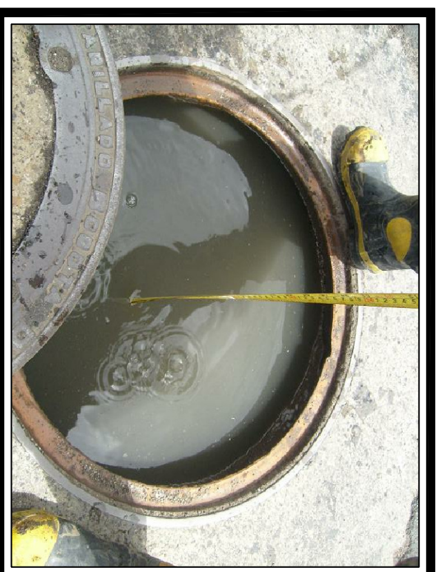
FOTO No. 2 Vista de la Cámara inundada
