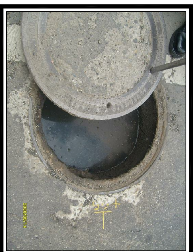
FOTO No. 2 Vista de la Cámara Inundada
