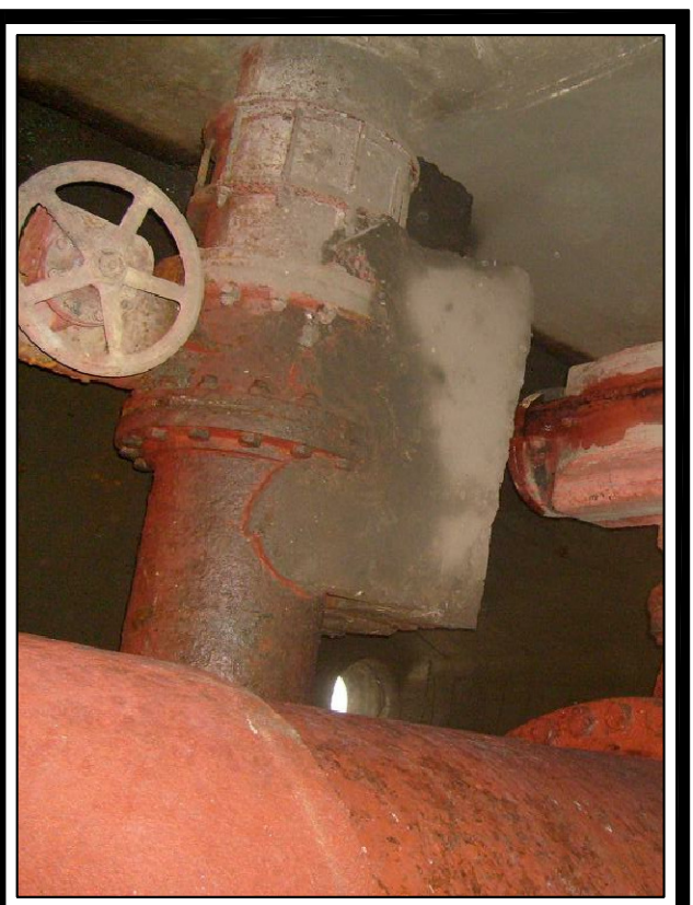
FOTO No. 5 Vista Interna de la Cámara (Purga)
