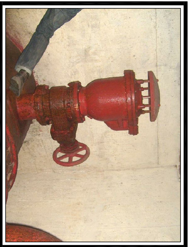
FOTO No. 3 Vista Interna de la Cámara (Ventosa)
