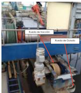
Puente desarenador desengrasador canales C/D
