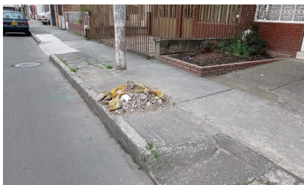
Imagen 16 – Punto intervenido sin recuperación de espacio público. Fuente: Visita de campo OCIG
