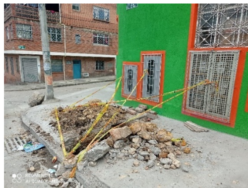
Imagen 17 – Evidencia estado espacio público posterior a intervención. Fuente: Visita de campo OCIG
