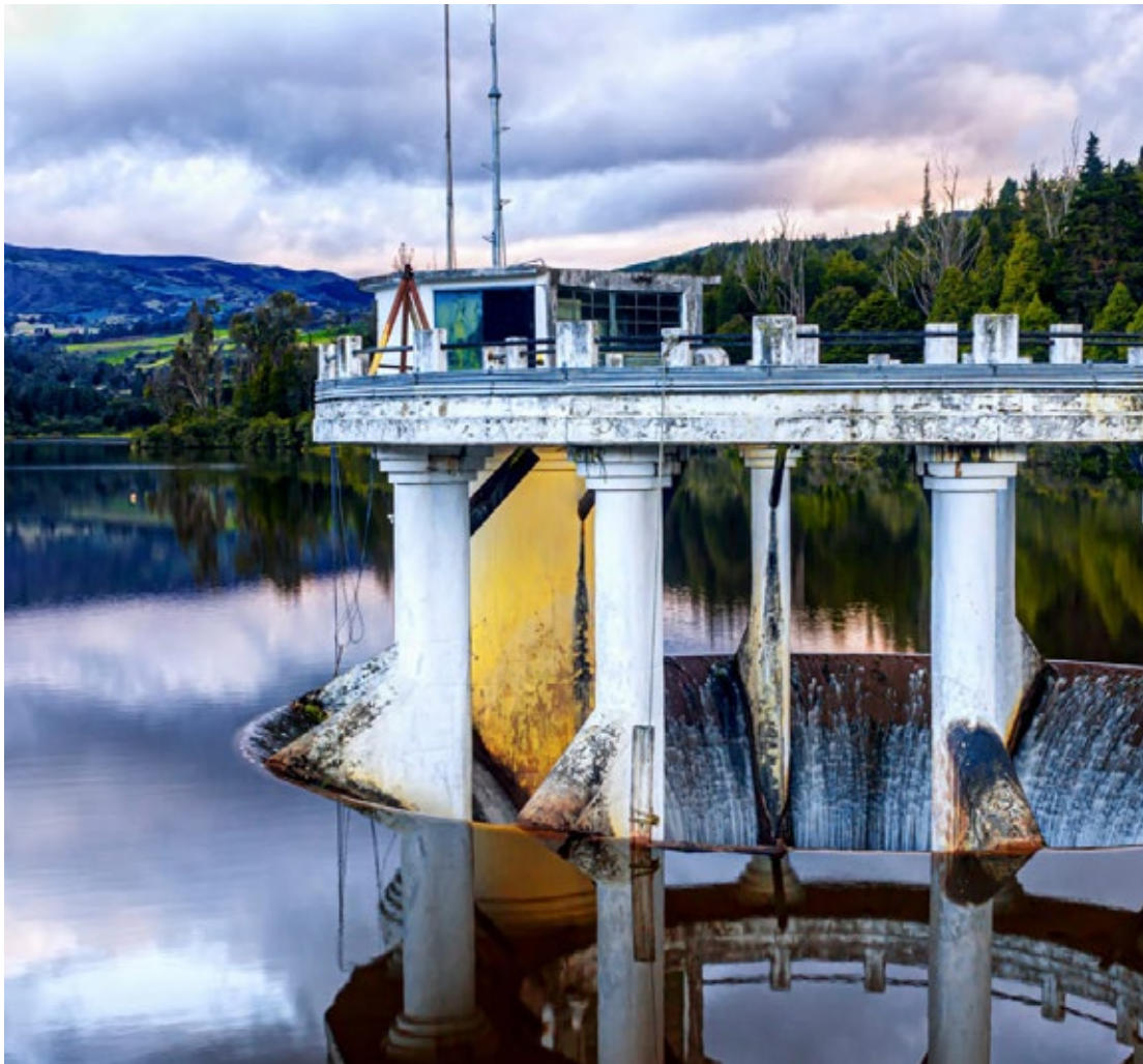
Rebosadero tipo Morning Glory - Embalse de La Regadera. Foto: Jaime A. Vargas.
