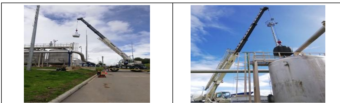
Fotografía 32. Mantenimiento filtros de biogás
