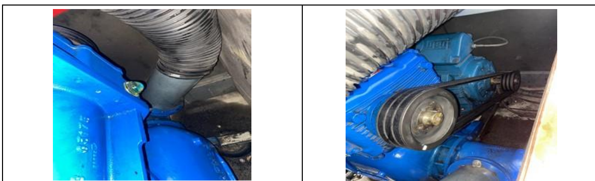
Fotografía 30. Mantenimiento soplante 079C001F
