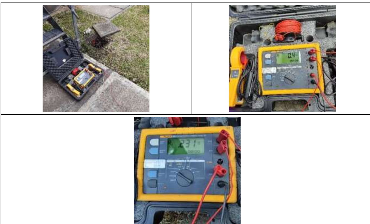
Fotografía 18. Medicion sistema puesta a tierra
