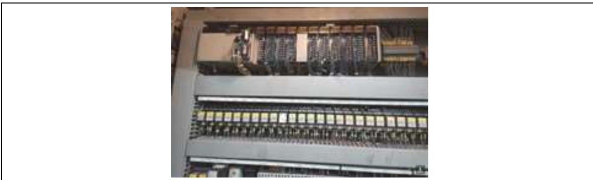
Fotografía 13. Migracion de PLC'S
