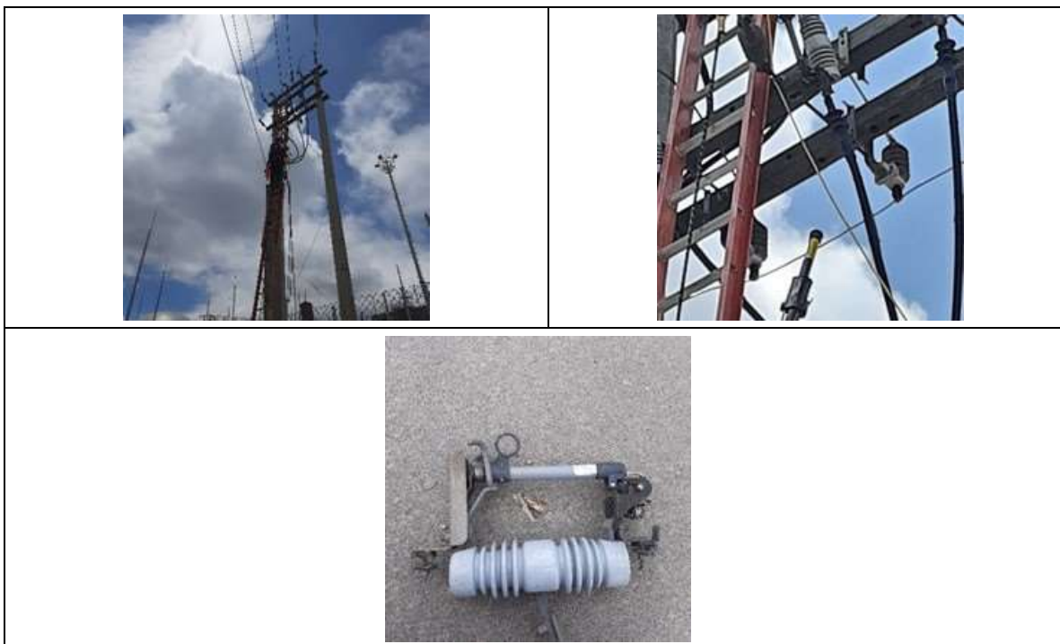
Fotografía 16. Fallas línea de media tension
