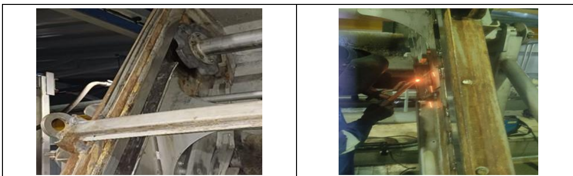
Fotografía 2. Mantenimiento reja de finos 051DGL002I
