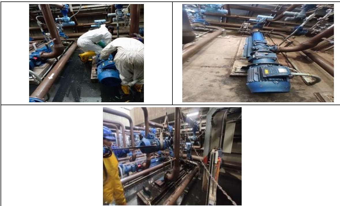
Fotografía 12. Mantenimiento bomba lodos digeridos a deshidratación 077P001C
