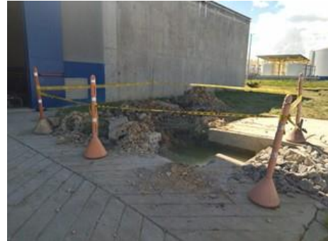
Señalización de huecos.
