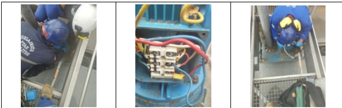
Fotografía 17. Mantenimiento clasificadores de arenas
