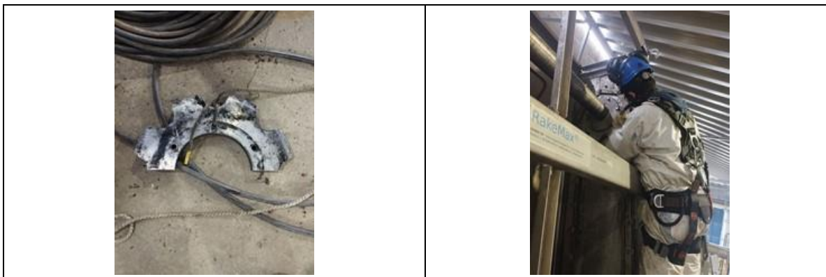
Fotografía 1. Mantenimiento reja de gruesos 051DGL001J
