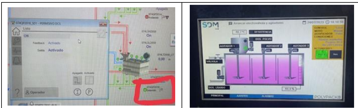
Fotografía 10. Mantenimiento skid de polímero 074QP201B
