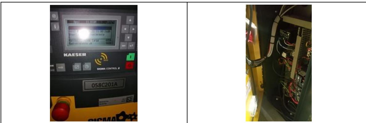
Fotografía 14. Mantenimiento compresores KAESER
