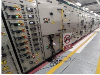
Pruebas eléctricas en el CCM
