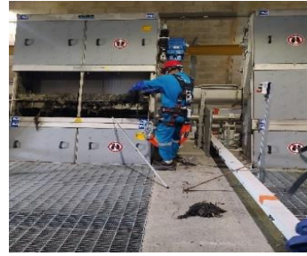
Limpieza del compactador en rejas finas
