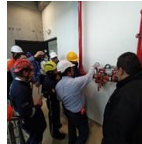
Capacitación red contra incendios
