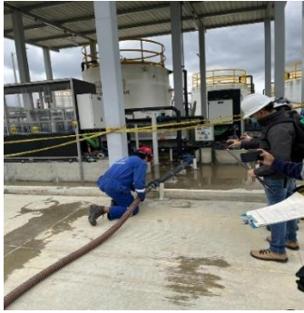
Derrame en hipoclorito
