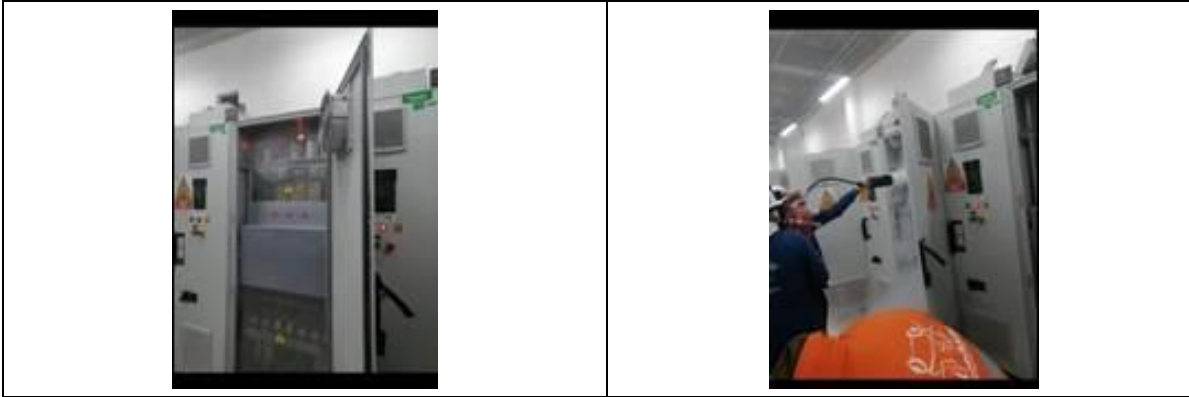
Fotografía 20. conato de incendio en el tablero de control del variador de frecuencia 053VDF002I
