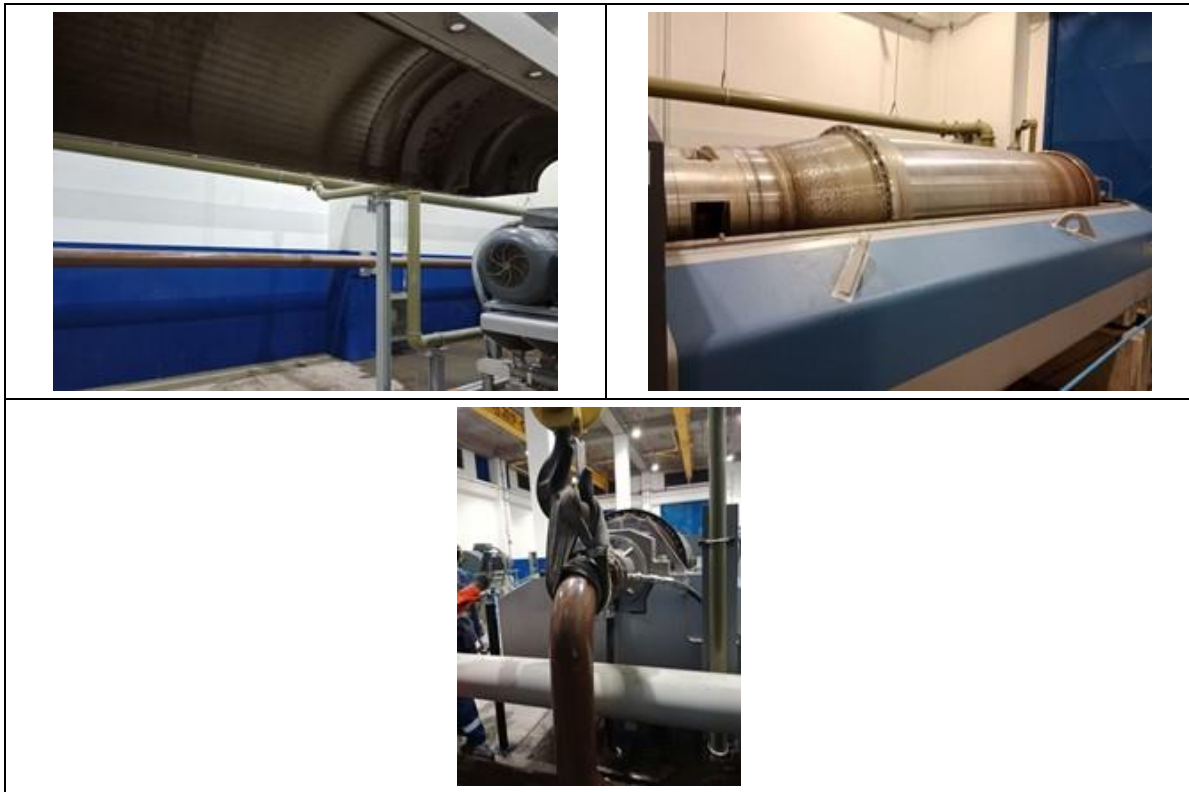
Fotografía 11. Mantenimiento centrifugadora 073SC002A
