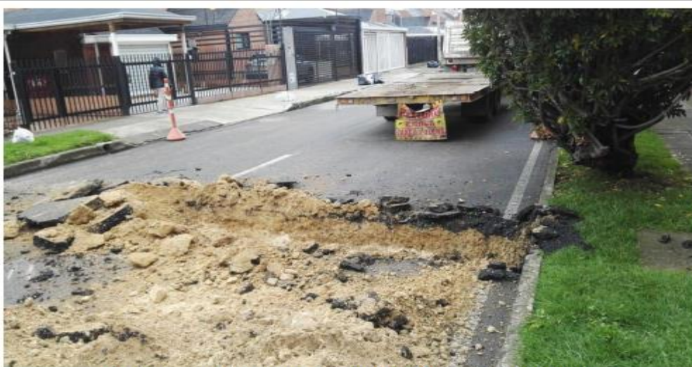
Foto No 7 Corrección de conexión errada CALLE 126 X CARRERA 52A
