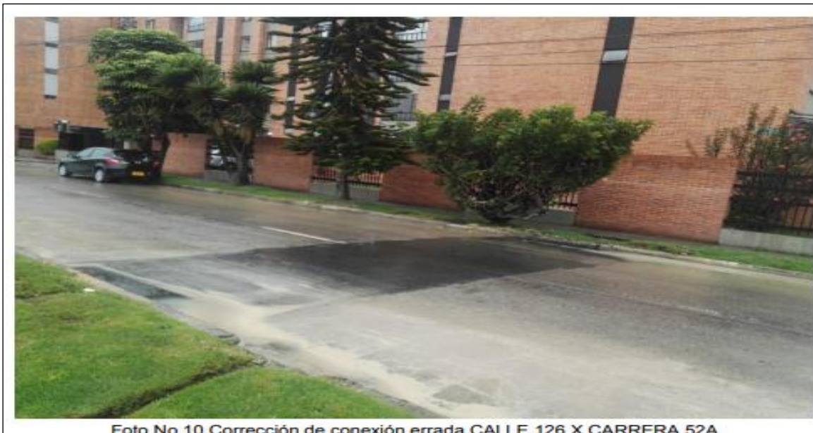
Foto No 10 Corrección de conexión errada CALLE 126 X CARRERA 52A
