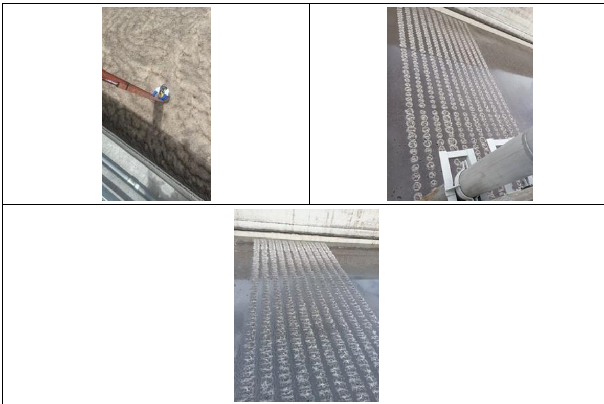
Fotografía 3. Mantenimiento difusores de burbuja fina balsa 4
