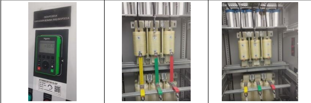
Fotografía 15. Mantenimiento variador bomba 065VFD301A
