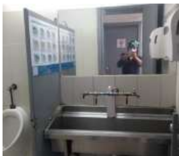
Instalación de instructivos de como lavarse las manos en el baño del taller de la PTAR Salitre
