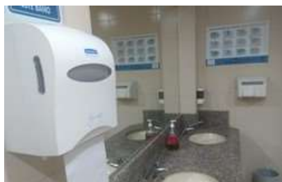
Instalación de instructivos de como lavarse las manos en el baño administrativo de la PTAR Salitre
