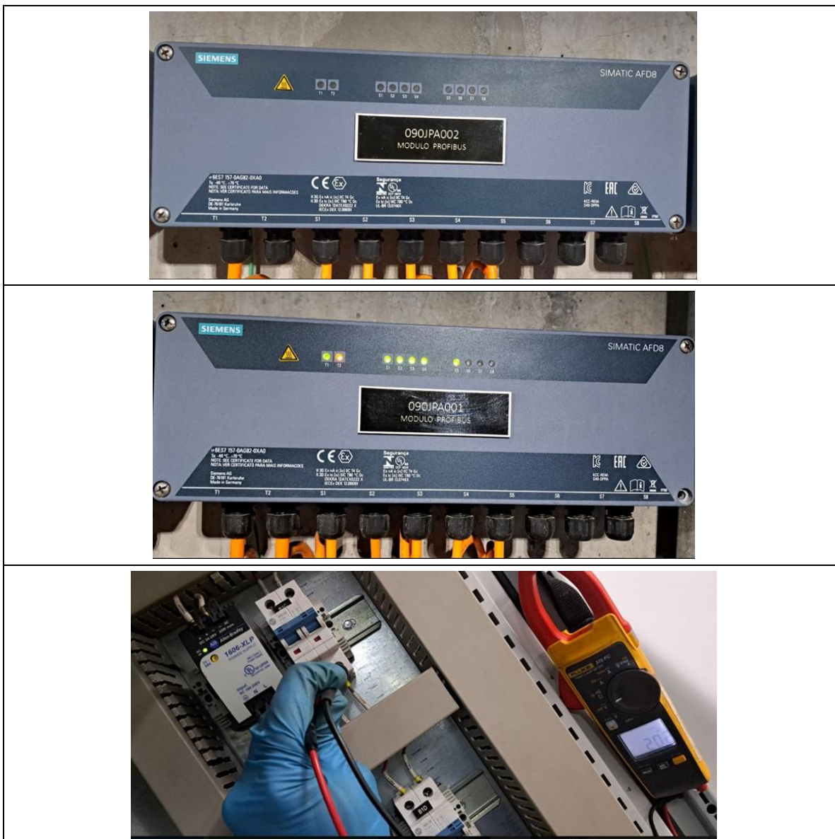
Fotografía 14. Mantenimiento modulo PROFIBUS 090JPA001 / 4
