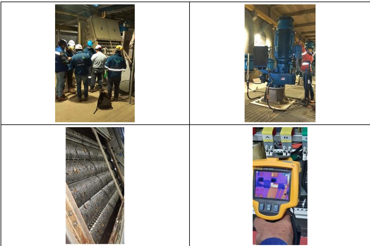
Fotografía 14. Verificación de equipos PTAR fase II
