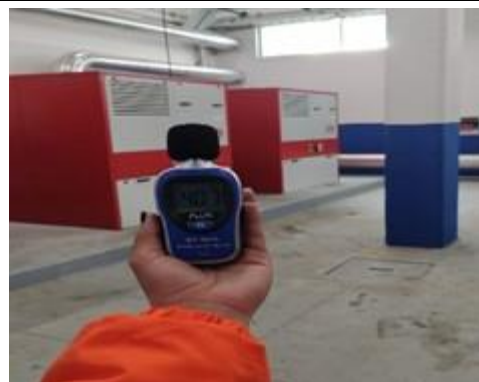
Mediciones de ruido en las diferentes áreas de la PTAR el Salitre fase II
