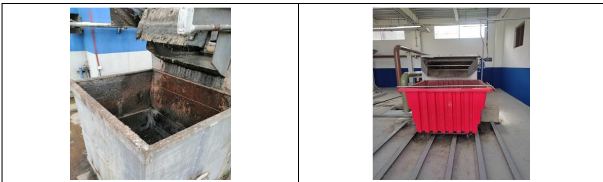
Fotografía 5. Contenedores del material cribado resultante de grasa galerías(sobrenadantes) y arenas
