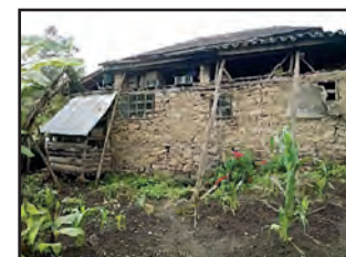
Agrietamiento de la Casa de Honorio Díaz, Vereda del Valle Sector el Palmar Fuente: Registro Fotográfico EPAM
