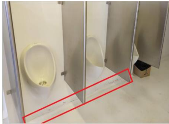
Fotografía 4: Deficiente remate en adecuación baños (sin dilatación entre muros y pisos) Fuente: Equipo auditor
