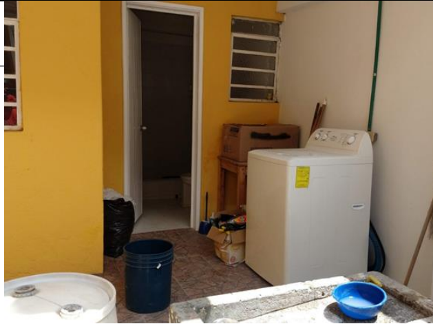
Fotografía: Reparaciones en vivienda afectada por inundación en desarrollo de contrato No. 1-01-34100-01061-2016 Fuente: Equipo Auditor
