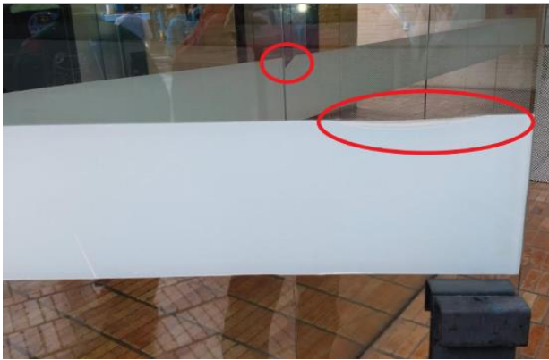
Fotografía 3: Deficiente calidad cintas sandblasting Fuente: Equipo auditor
