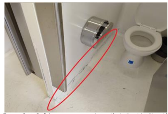
Fotografía 6: Deficiente remate en adecuación baños (sin dilatación entre muro y piso) Fuente: Equipo auditor
