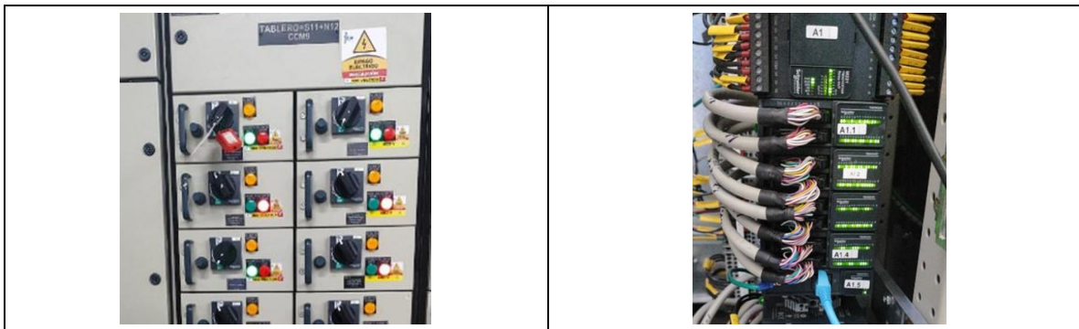
Fotografía 6. Mantenimiento PLC del CCM 9
