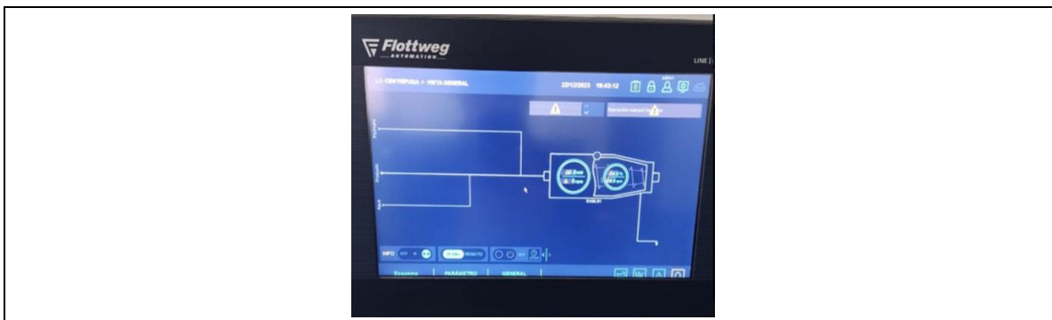
Fotografía 5. Mantenimiento tarjeta de red de la centrifuga 073SC001B
