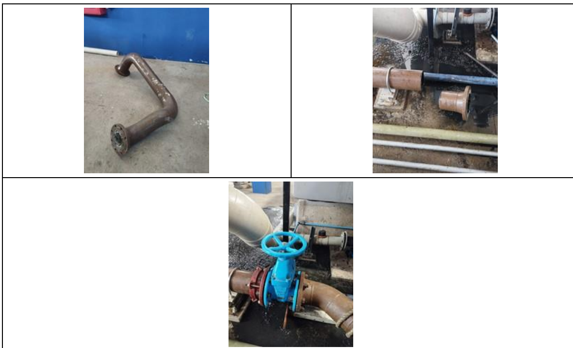
Fotografía 10. Mantenimiento línea de la centrifuga 073SC001B
