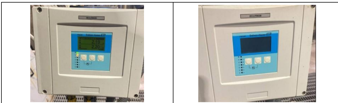
Fotografía 4. Mantenimiento transmisor 051LIT002B
