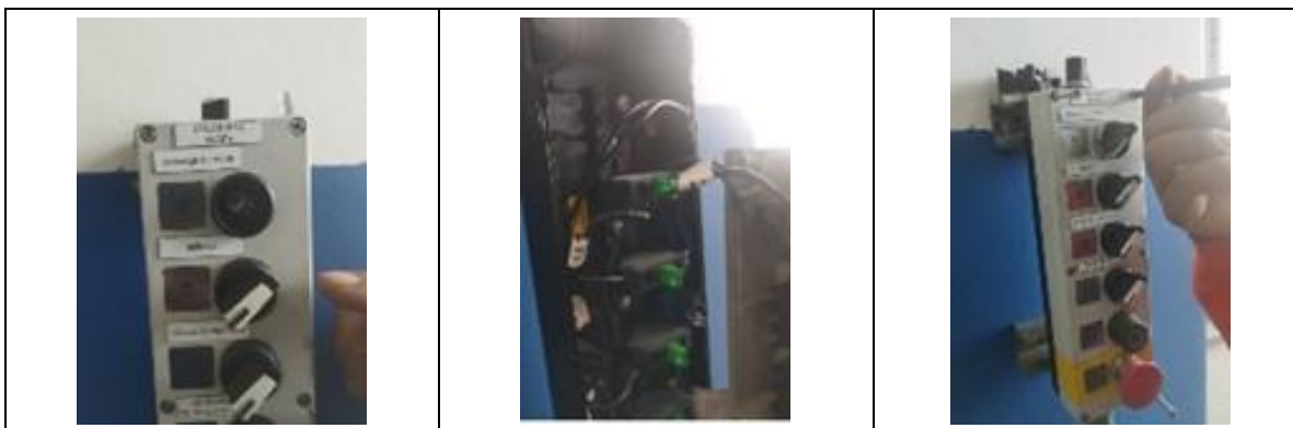
Fotografía 12. Mantenimiento selector de posición 079LCB001E
