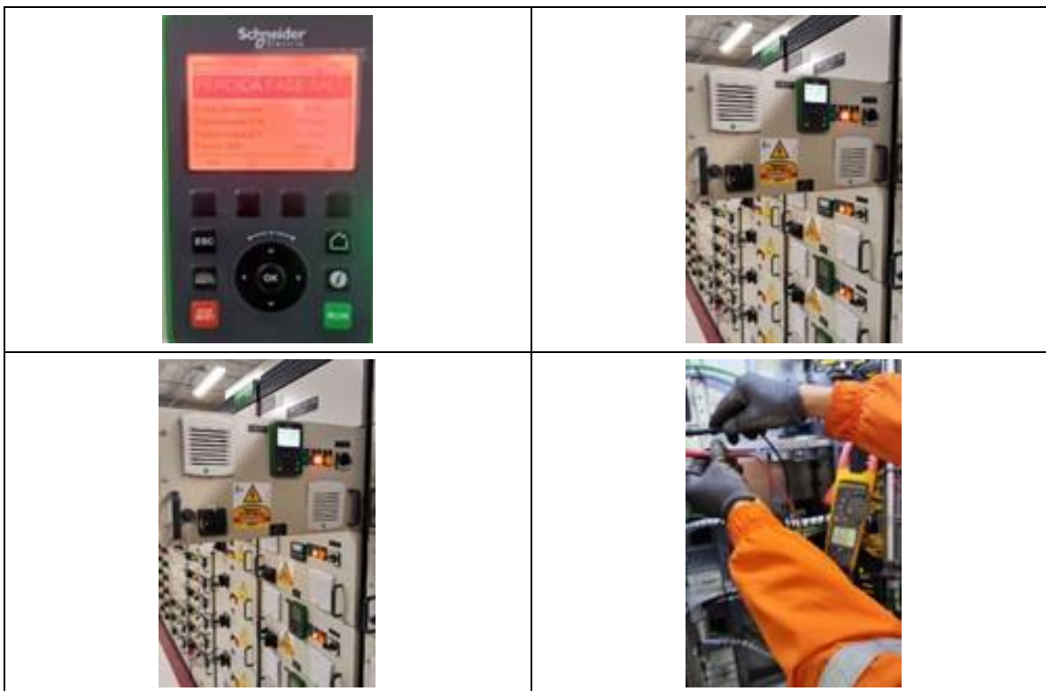
Fotografía 11. Mantenimiento bomba polielectrolito deshidratación de lodos 074P202A
