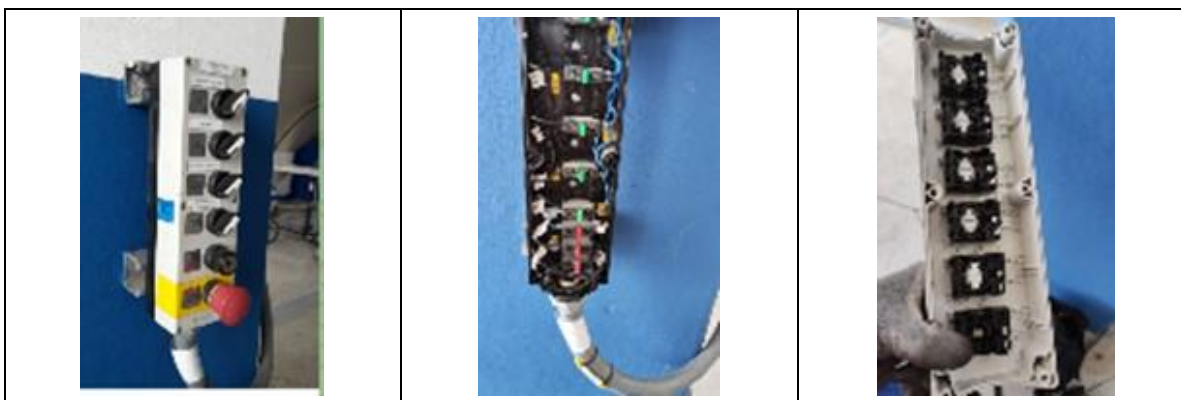
Fotografía 10. Mantenimiento selector de posición de remoto manual 079DCA201B
