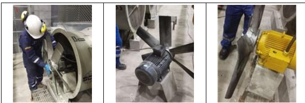
Fotografía 8. Mantenimiento motor ventilador 071MXV110D generador 4
