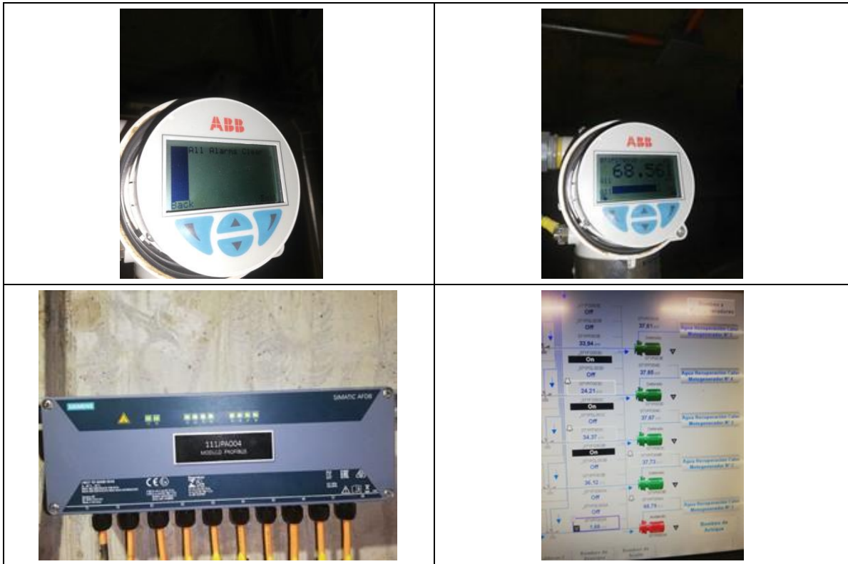
Fotografía 19. Mantenimiento instrumentos de medida cogeneracion y recuperacion de calor
