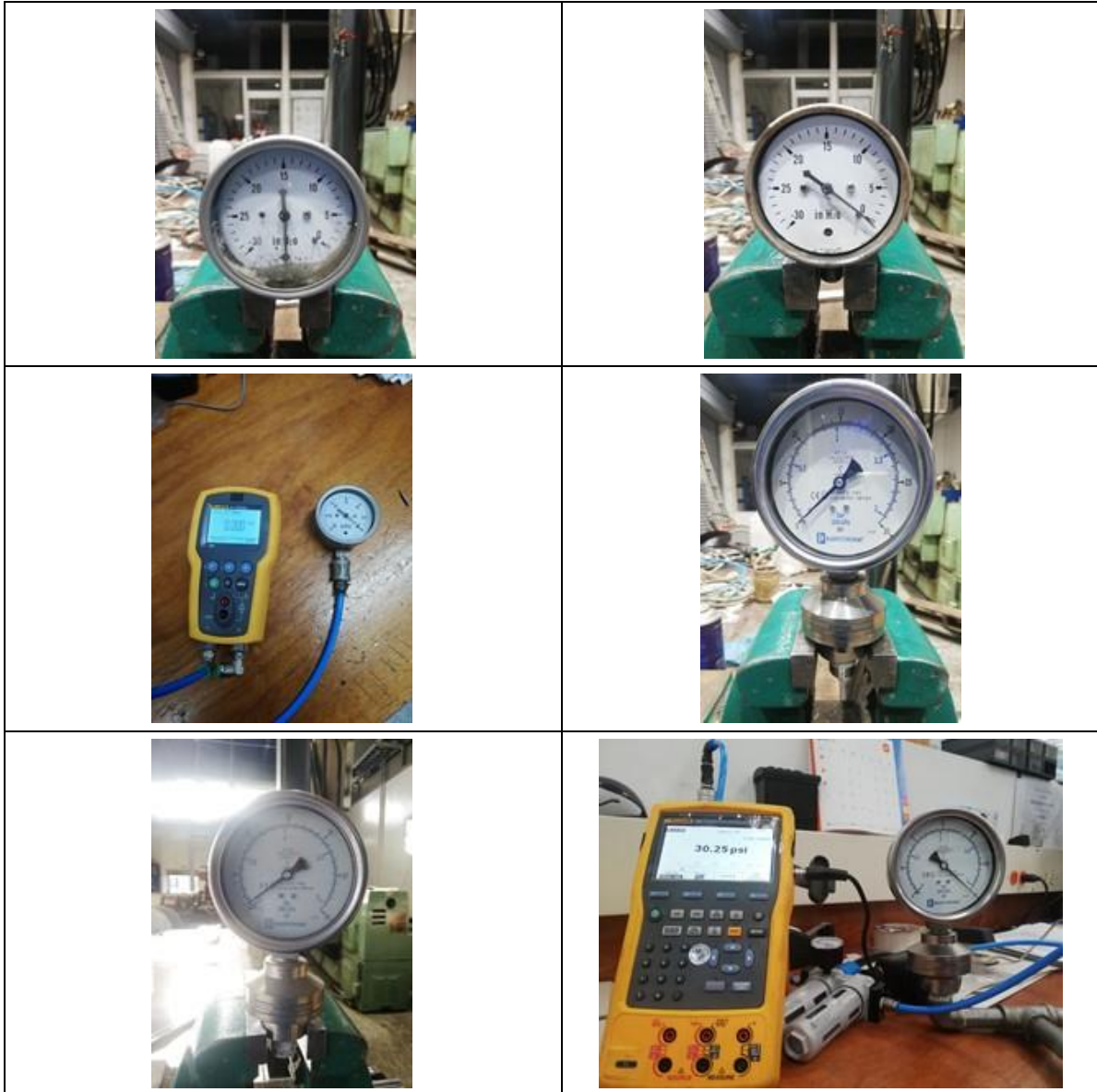
Fotografía 17. mantenimiento preventivo a indicadores de presión
