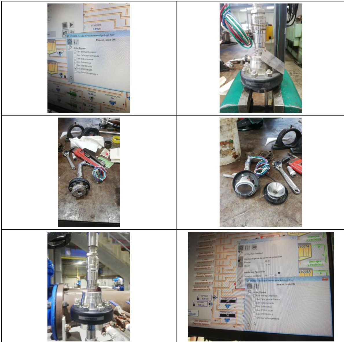
Fotografía 18. mantenimiento preventivo al interruptores de presión
