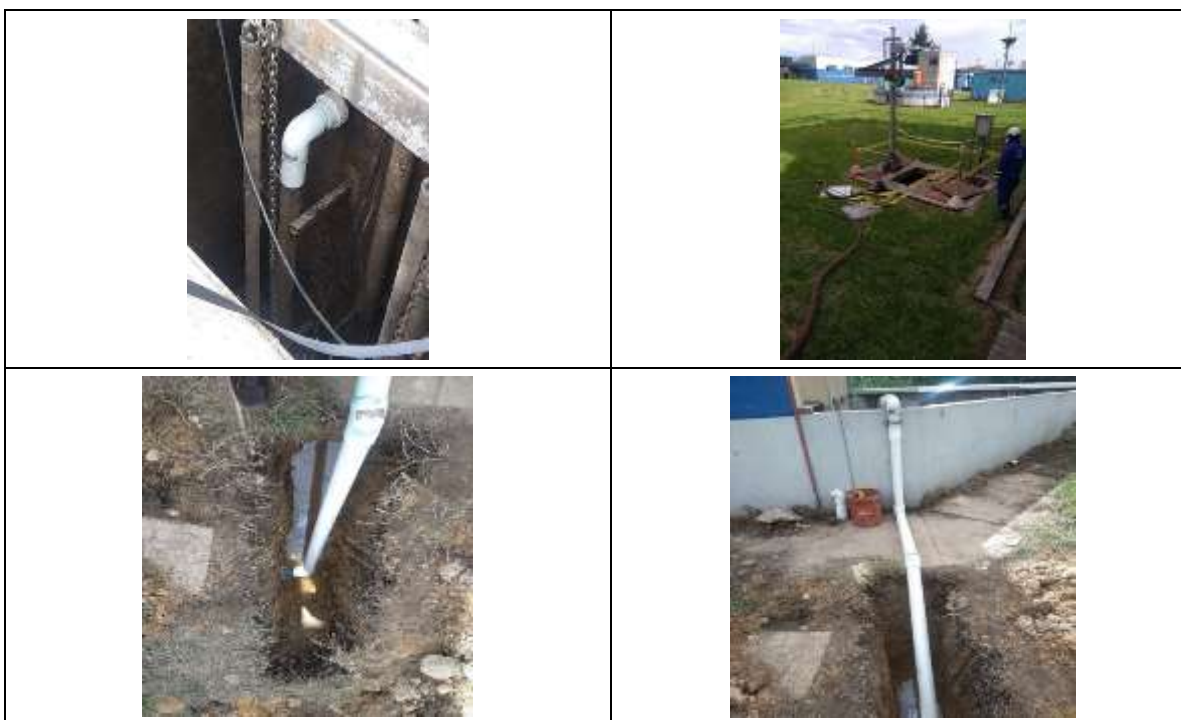
Fotografía 8. Reparación Fuga Edificio 26
