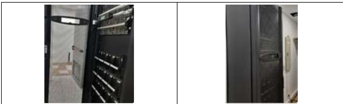
Fotografía 13. Traslado de la UPS del edificio administrativo
