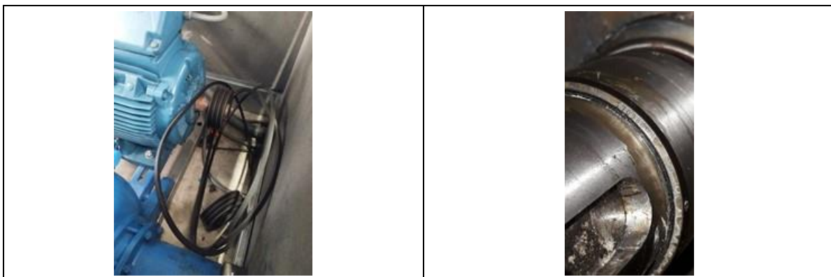
Fotografía 3. Mantenimiento soplador MAPNER 079C001D
