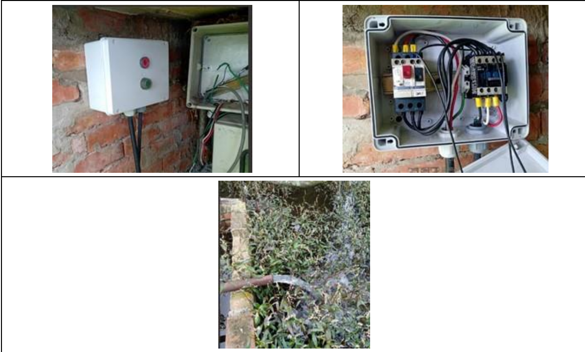
Fotografía 20. Mantenimiento bomba piezométrica
