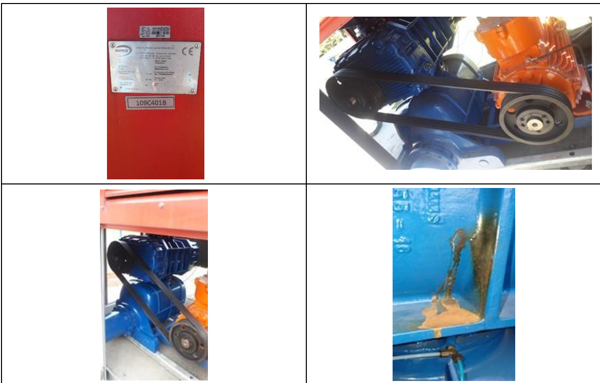
Fotografía 13. Revisión sopladores de biogas
