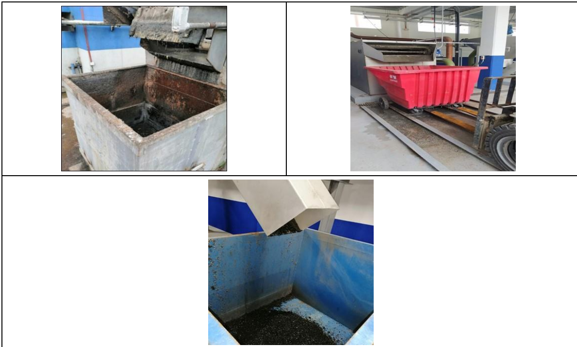
Fotografía 7. Residuos de pretratamiento provenientes del descargue de contenedores del material cribado resultante de Gruesos y Finos.
