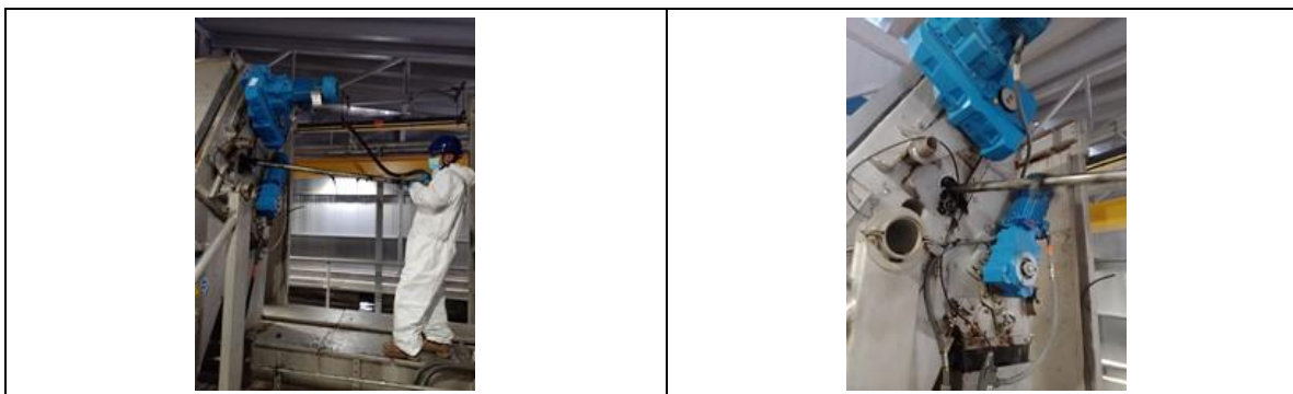
Fotografía 1. Mantenimiento flautas de las rejas de finos 051DGL002A/J
