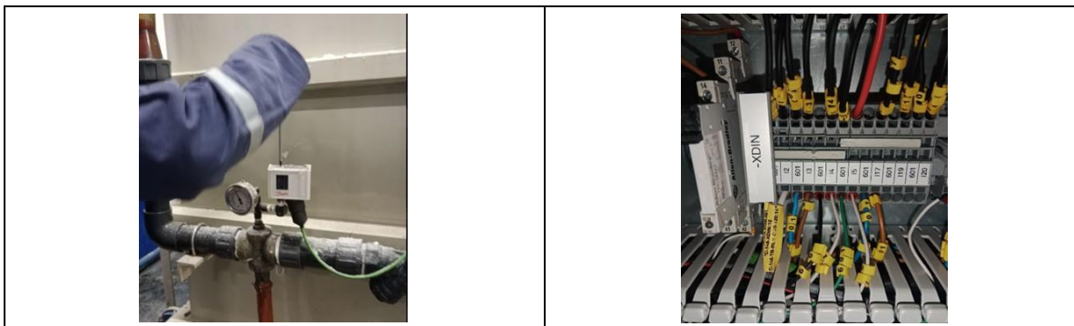
Fotografía 11. Mantenimiento fuentes bombas 053P002F / 065P301C
