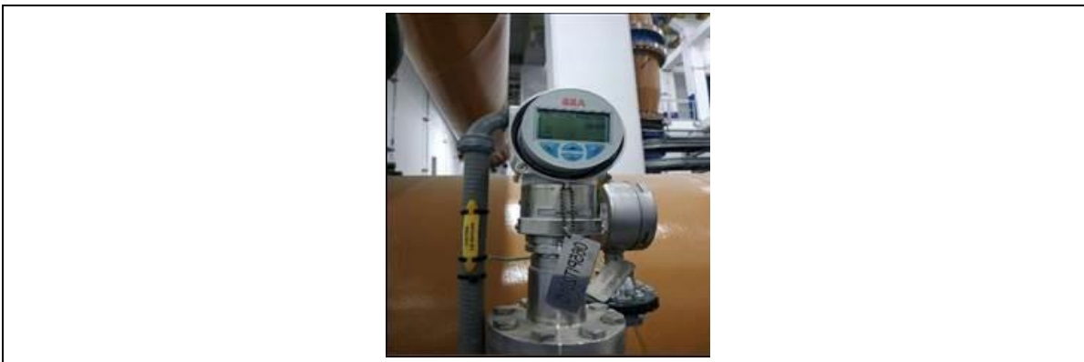
Fotografía 19. Mantenimiento preventivo a los PIT's indicadores de presión de Ras/Was 2
