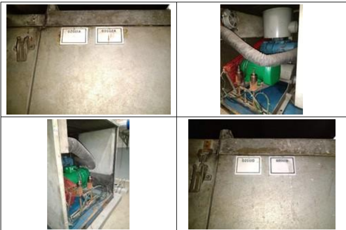
Fotografía 11. Mantenimiento sopladores Robuschi
