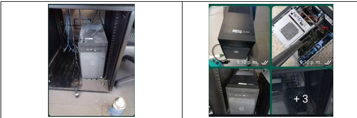
Fotografía 16. Mantenimiento WorkStation sala de control
