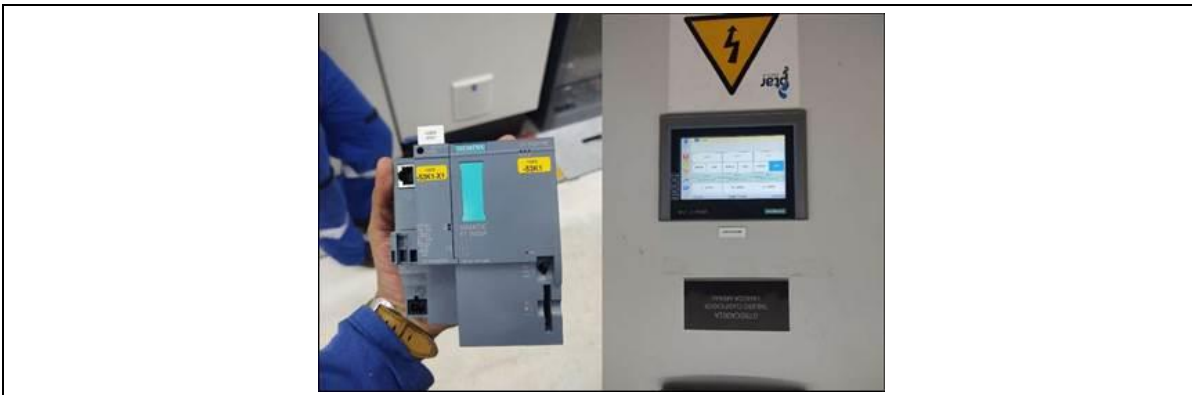
Fotografía 23. Mantenimiento preventivo computadores de sala de control.
