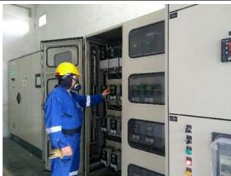
Inspección y seguimiento en el uso de E.P.P., actividades de verificación dentro de control de motores
